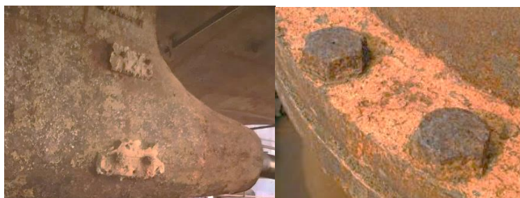
Slika 2.6 Opća korozija podvodnog dijela brodskog trupa [12]
