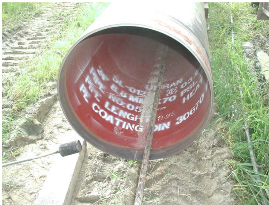
Slika 3. Čelična plinovodna cijev (X70) promjera 24" i debljine stjenke 8.8 mm.
