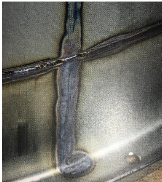
Slika 2.10 Pobojenost površine uzrokovana djelovanjem topline pri zavarivanju [16]
